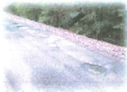
路面穴ぼこ・陥没 [例]路面段差
