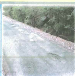
舗装の穴ぼこ・陥没
